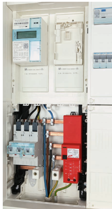
14 SPDs Typ 1 im unteren Anschlussraum des Zählerschranks
