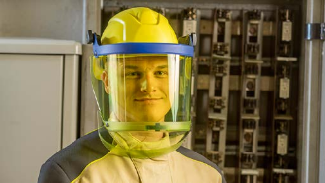
Monteur in einer Niederspannungsschaltanlage.
