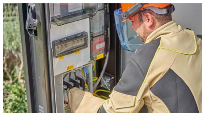
Wartung von Ladesäulen.
