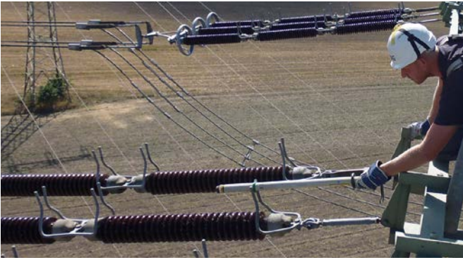
Hochspannungsanzeiger an einer 110 kV-Freileitung.
