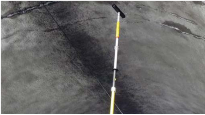
Entfernen von Eiszapfen an Tunnelleinfahrt.
