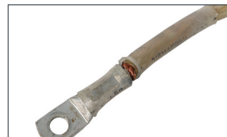
Hervortreten des blanken Leiterseils an gebrochener Seileinführung.
