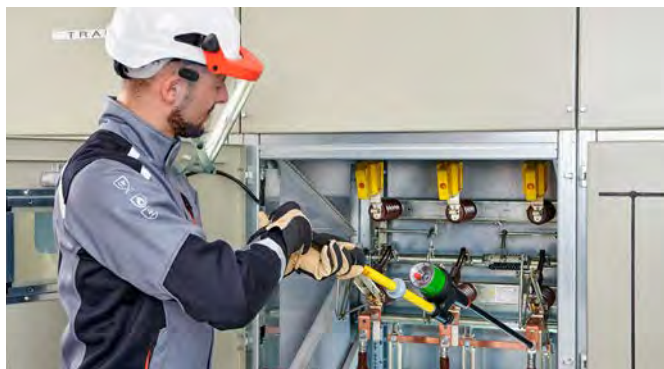
Einpoliger Phasenvergleichler PHV I an einer Schaltanlage.
