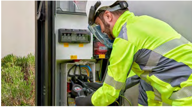
Wartung von Ladesäulen.
