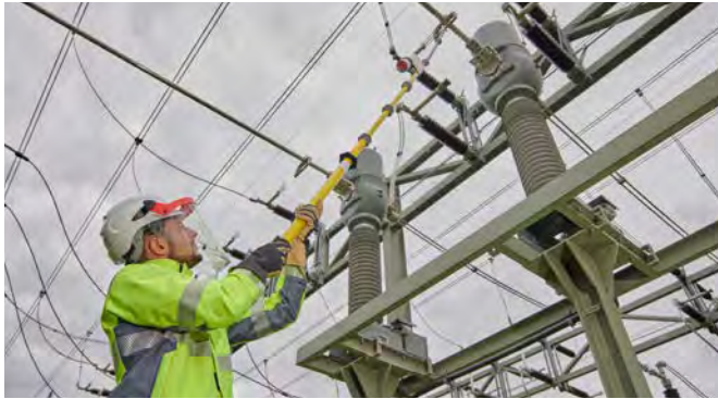
Spannungsprüfer PHE4 an einer Freiluftstation 110 kV.
