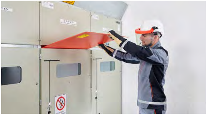
Einbringen einer Schutzplatte der Bauform A4 in eine geschlossene Anlage.
