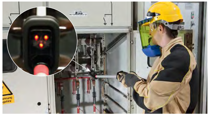
Spannungsprüfer PHG II an einer typgeprüften Schaltanlage.
