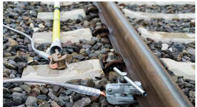
Schienenanschlussklemme am Schienenprofil montiert.
