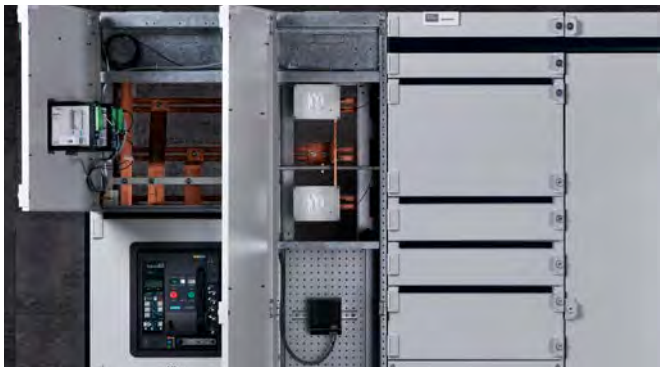
Aktives Störlichtbogenschutzsystem DEHNshort eingebaut in einer Schaltanlage.
