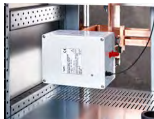
Löscheräte im eingebauten Zustand
