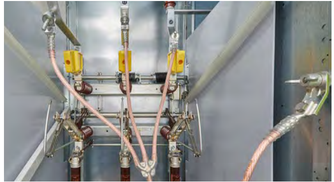
Bestückte dreipolige Erdungs- und KurzschlieBvorrichtung in einer Schaltanlage.
