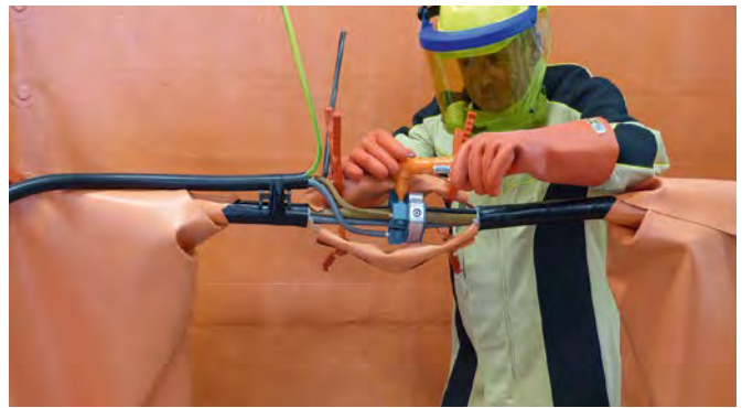
Abdecken von unter Spannung stehenden Teilen.
