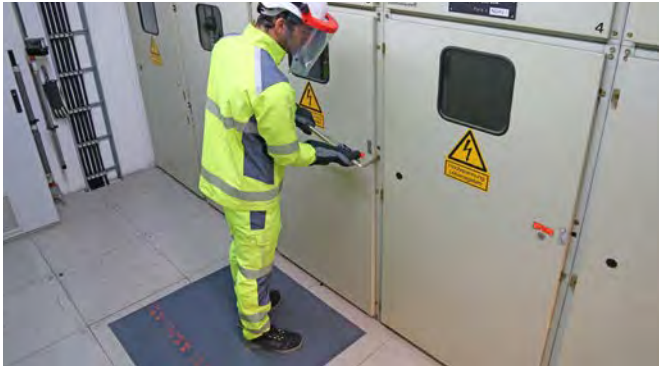
Schaltraum mit ausgelegter Isoliermatte.
