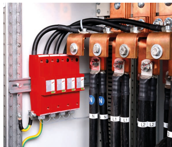
Bild 13 Schutz der Einspeisung in der Gebäudehauptverteilung mit DEHNvenCI
