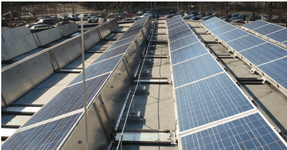
Bild 14 Rooftop PV system
