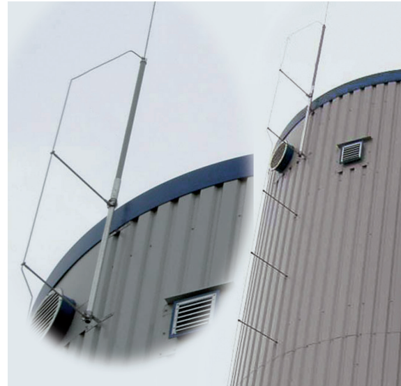
Figure 9.3.7 Protection du digesteur en panneaux métalliques à l'aide d'un dispositif de capture isolé (source : Büro für Technik à Hösbach)
